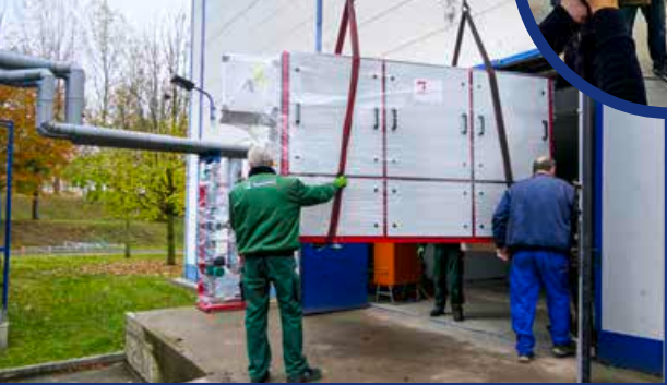
5. November 2019: Anlieferung des Erdgas-BHKW
