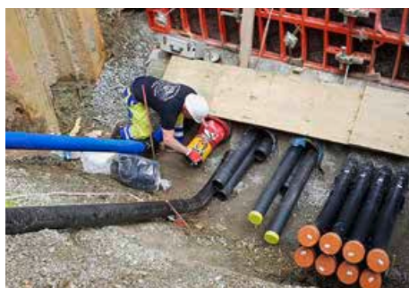
Gert Hofmann bei der Vorbereitung der Schweißverbindung an der neu zu verlegenden Gasleitung.
