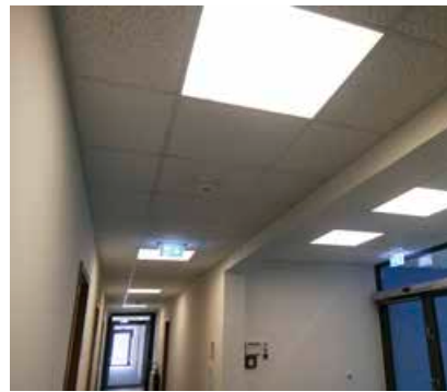
Alt gegen Neu: Im Firmengebäude der Stadtwerke Reichenbach wurde auf energieeffiziente LED-Beleuchtung umgestellt.
